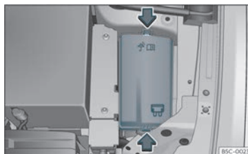
Fig. 52 Al compartiment del motor: tapa de la caixa de fusibles.
