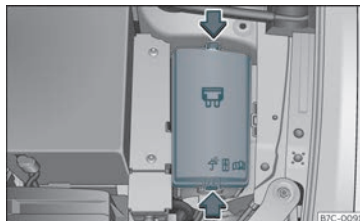
Fig. 46 No van motor: tapa da caixa de fusibles.
